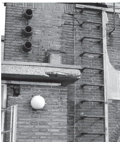
Door roestvorming uit elkaar gedrukt metselwerk en betonrot, gezien vanaf een van de vele platte daken.
